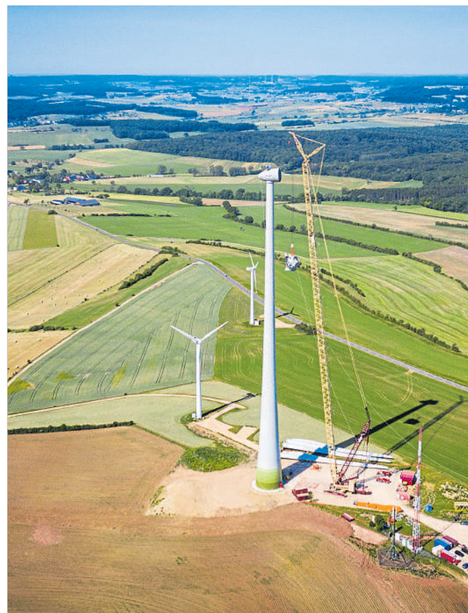
Am Pafeberg bei Mompach wurde erst jüngst ein, samt Rotor, über 200 Meter hohes Windrad errichtet.
